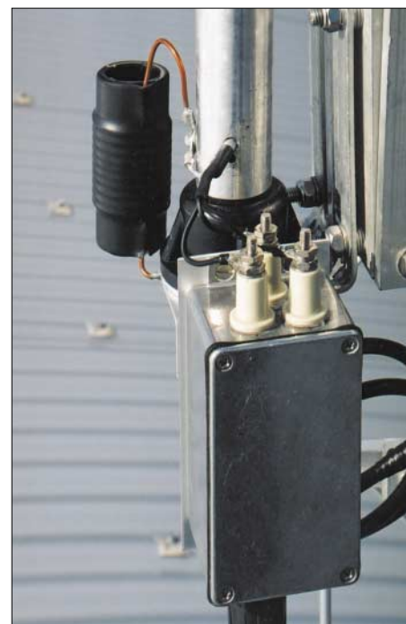
Bild 3: Das im unteren Bildteil erkennbare Aluminiumgehäuse beinhaltet die Abblockung für die drei Leiter des Steuerkabels.
