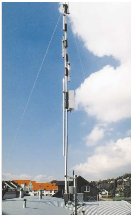
Bild 1: Betriebsbereite Antenne auf dem Dach aus Wellblechbahnen; etwa in der Mitte ist das wetterfeste Gehäuse zu erkennen, das den Drehkondensator und Motor aufnimmt.
