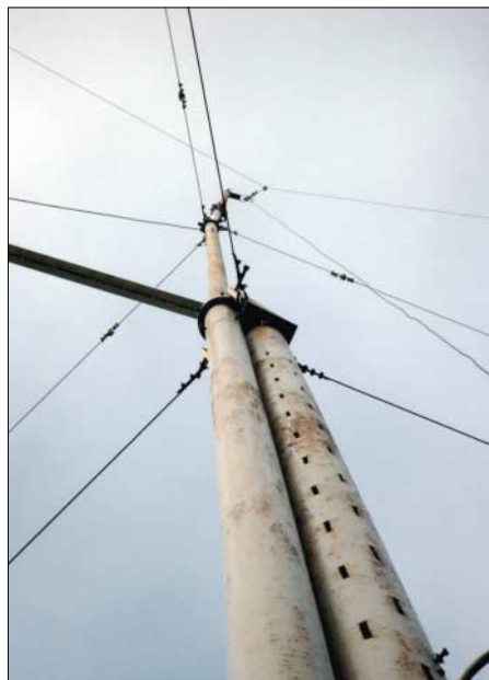
Bild 3: Schaden am Mast der 4-El.-40-m-Yagi
